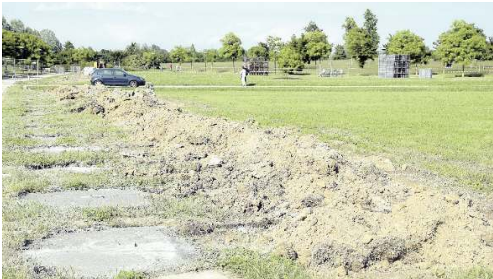
CANTIERE Gli scavi e il cemento comparsi al parco San Giuliano in vista dell'arrivo delle strutture dell'Home Venice (Nuove Tecniche/Claudio Springolo)
